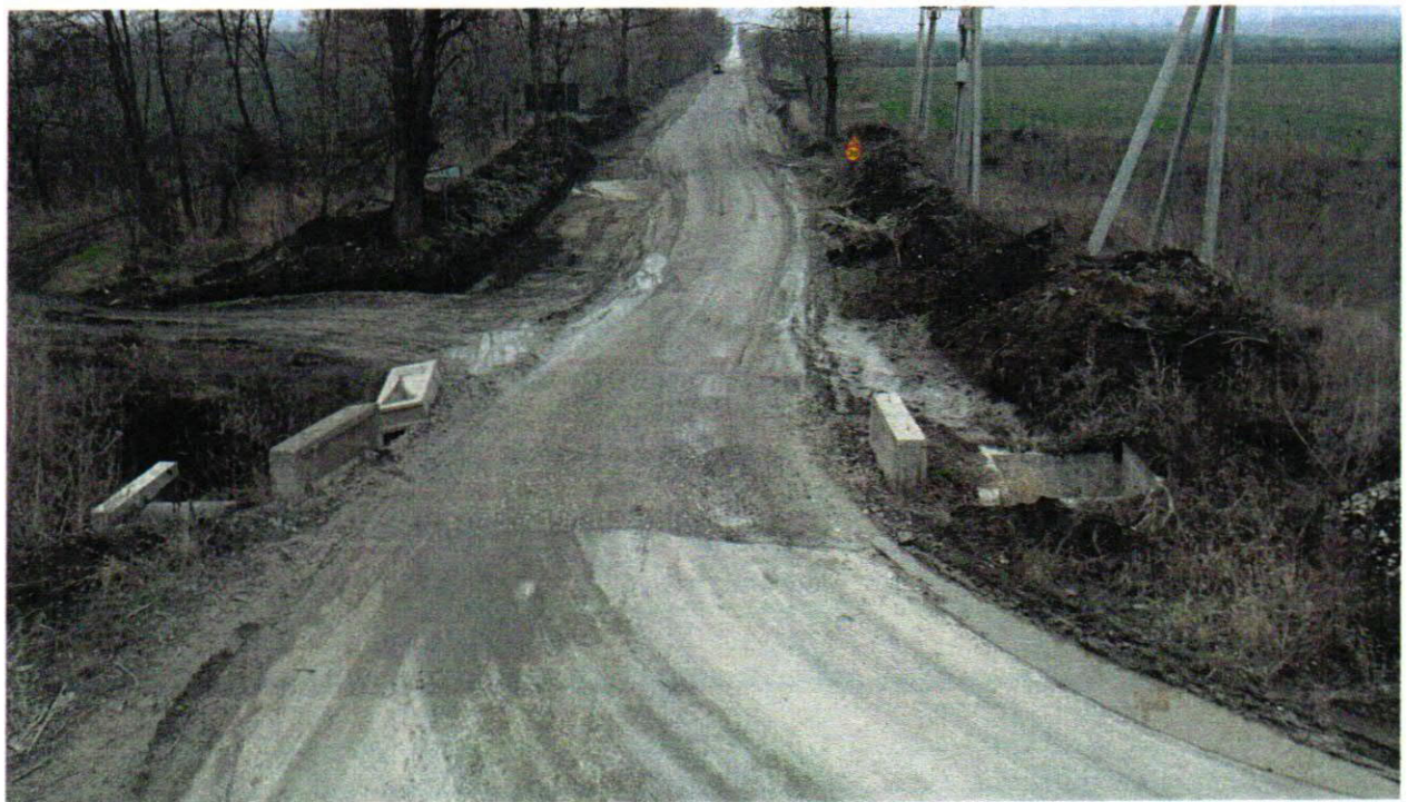
Figura 20. Drumul L103, Podețul Pc 36+70 (sens invers). Starea/Etapa executată la faza de expertiză
