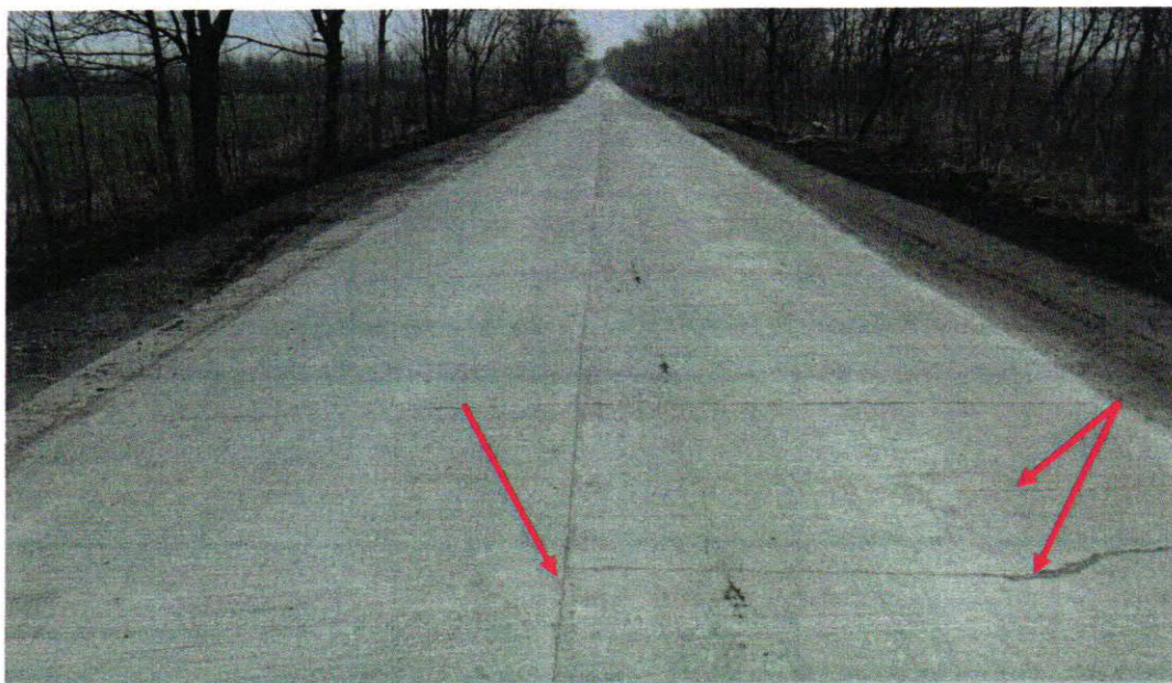
Figura 4. Km 2+640. Deschiderea rostului longitudinal (fază incipientă).
