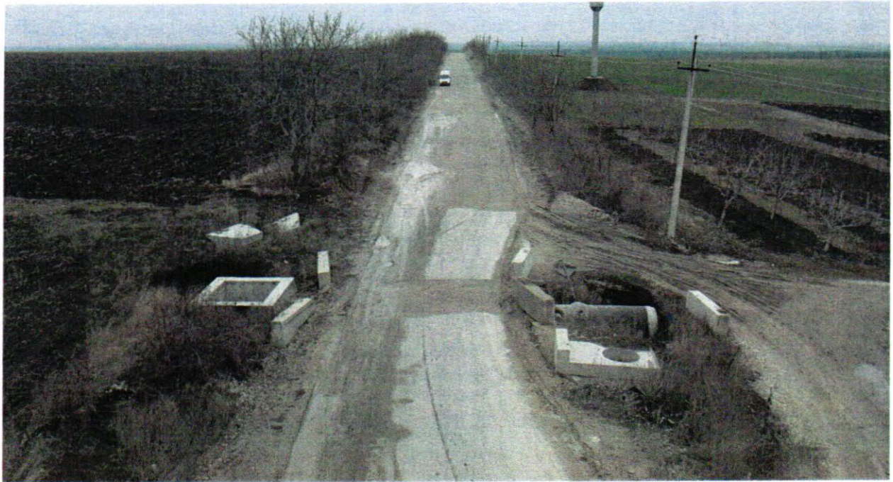
Figura 19. Drumul L103, Podețul PC 14+98. Starea/Etapa executată la faza de expertiză
